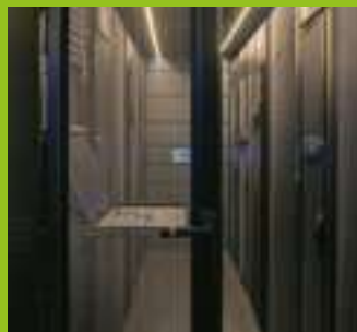
Le système de refroidissement du data center de Q1C1
